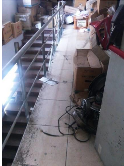
Şekil 3.7: Yangın merdivenlerinin depo alanı olarak kullanılması
