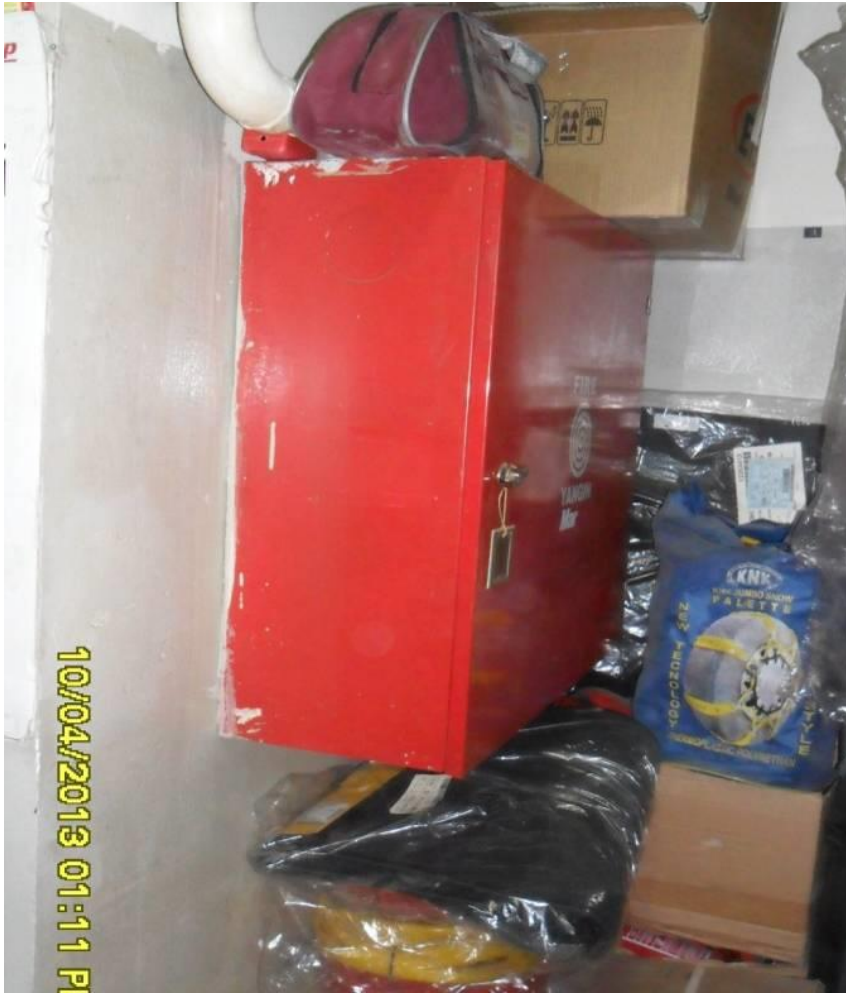
Şekil 3.3: Yangın söndürme dolabının erişilemez durumu
