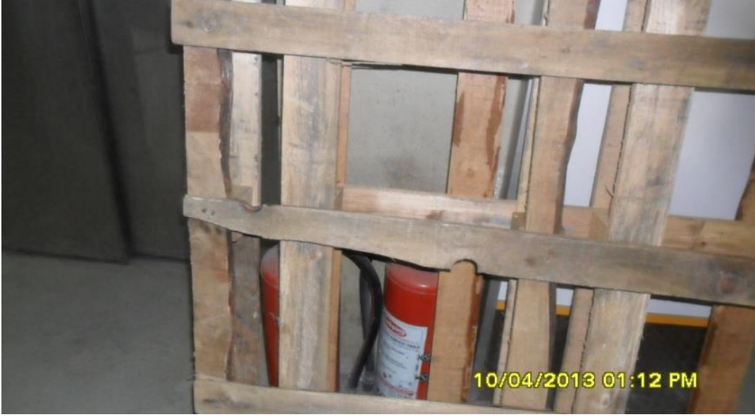
Şekil 3.2: Bir İşyerinde erişilemez yangın söndürme tüpleri
