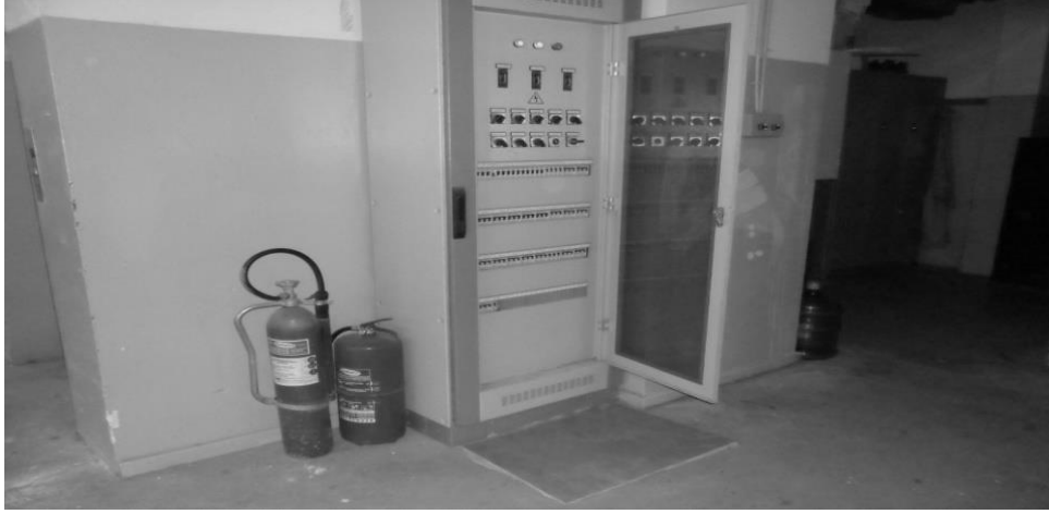
Şekil 3.5: Elektrik panosu yanında yangın söndürme tüpleri
