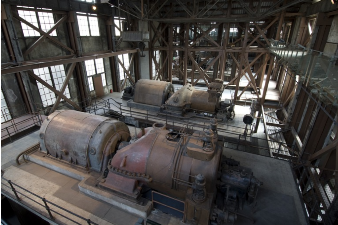
Şekil 4.24: Türbin ve Jeneratör Grubu [46]
