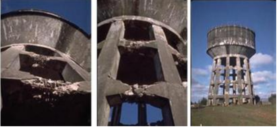
Şekil 2.4: Depremde 700 m 3 kapasiteli yükseltilmiş su deposu 1960 Şili
