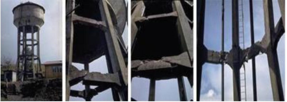
Şekil 2.1: Puerto Varas Hotel'in yükseltilmiş su deposu, Şili depremi [2].
