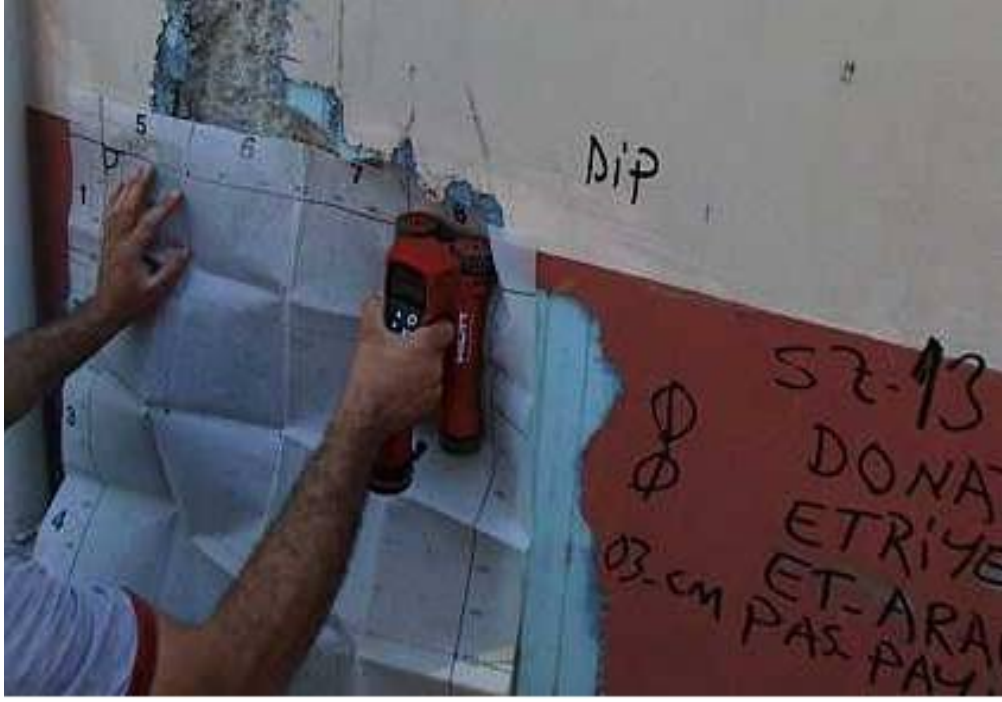
Şekil 3.32 : Tahribatsız yöntem (röntgen taraması) ile donatı tespiti işlemi
