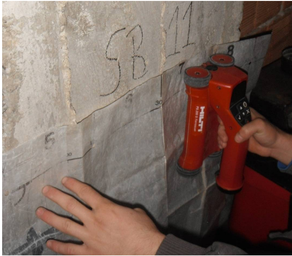
Şekil 3.31 : Tahribatsız yöntem (röntgen taraması) ile donatı tespiti işlemi
