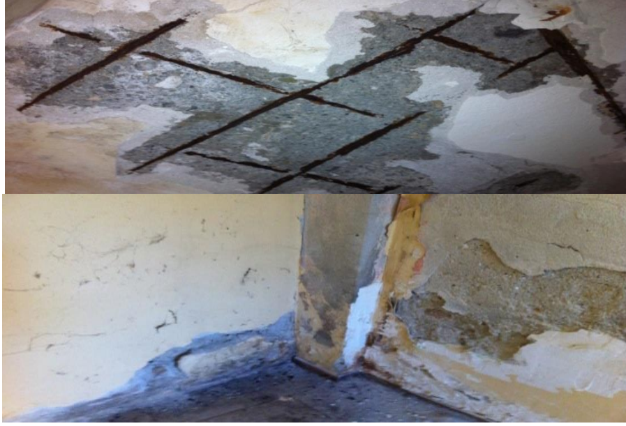
Şekil 42: Yapı-9 Döşemelerde Korozyon Durumu ve Kolon, Duvar da Görülen Yapısal Hasarlar
