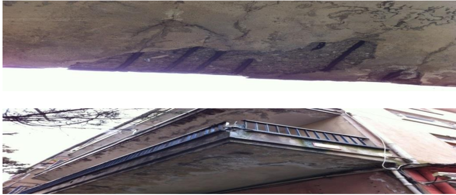
Şekil 45: Yapı-10 Döşemelerde Korozyon Durumu ve Kolon, Duvar da Görülen Yapısal Hasarlar
