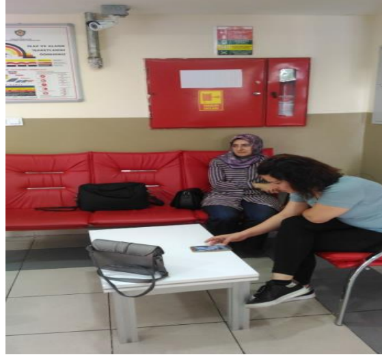
Şekil 3.16: Okullarda önünde malzeme bulunan yangın dolapları
