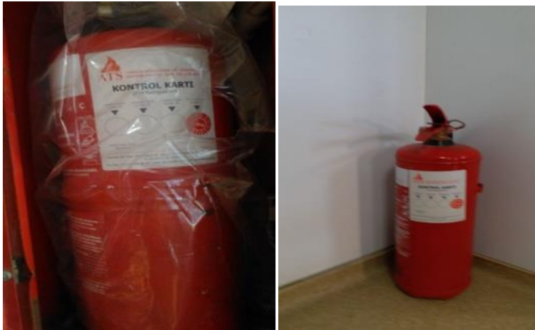
Şekil 3.19: Yangın söndürme tüpleri
