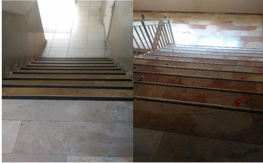
Şekil 3.5: Okullarda merdivenlerdeki kaymaz bantlar
