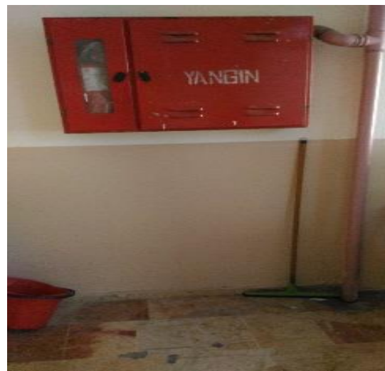
Şekil 3.15: Okullarda bulunan yangın dolapları
