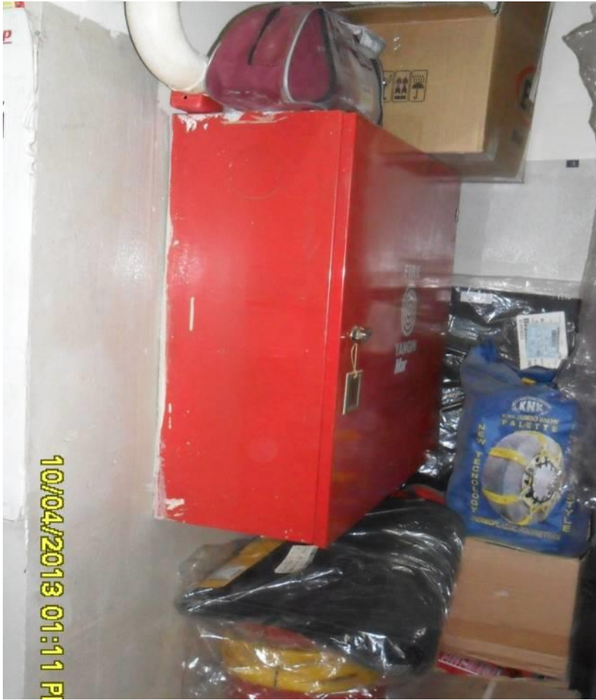
Şekil 3.3: Yangın söndürme dolabının erişilemez durumu
