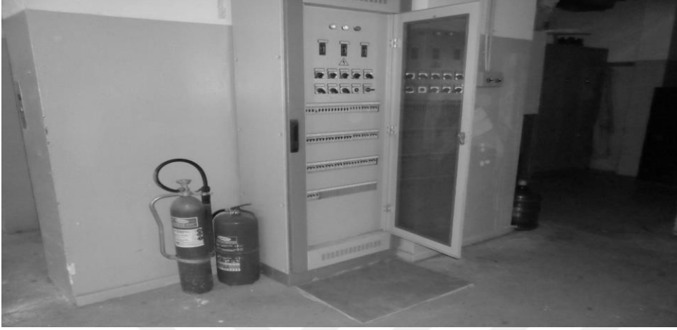
Şekil 3.5: Elektrik panosu yanında yangın söndürme tüpleri
