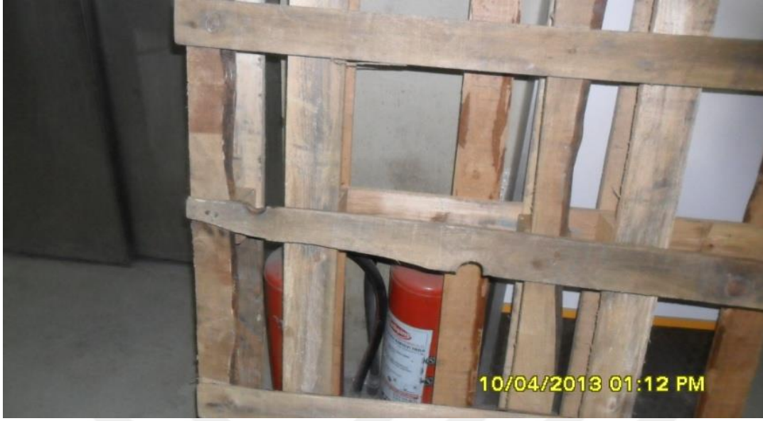
Şekil 3.2: Bir İşyerinde erişilemez yangın söndürme tüpleri
