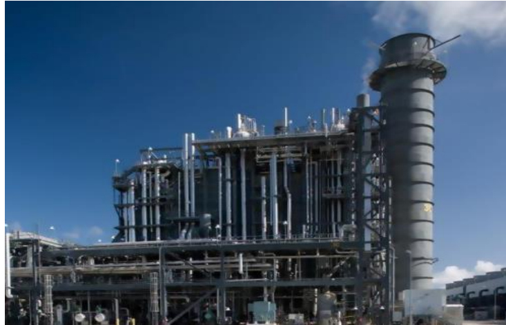
Figure 10 Typical Large HRSG
