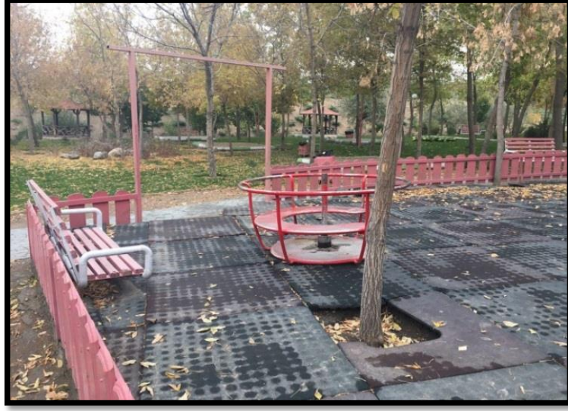
Şekil 6.36: Zeminde kot farkı oluşması (Aysan Danesharasteh kişisel arşivi)
