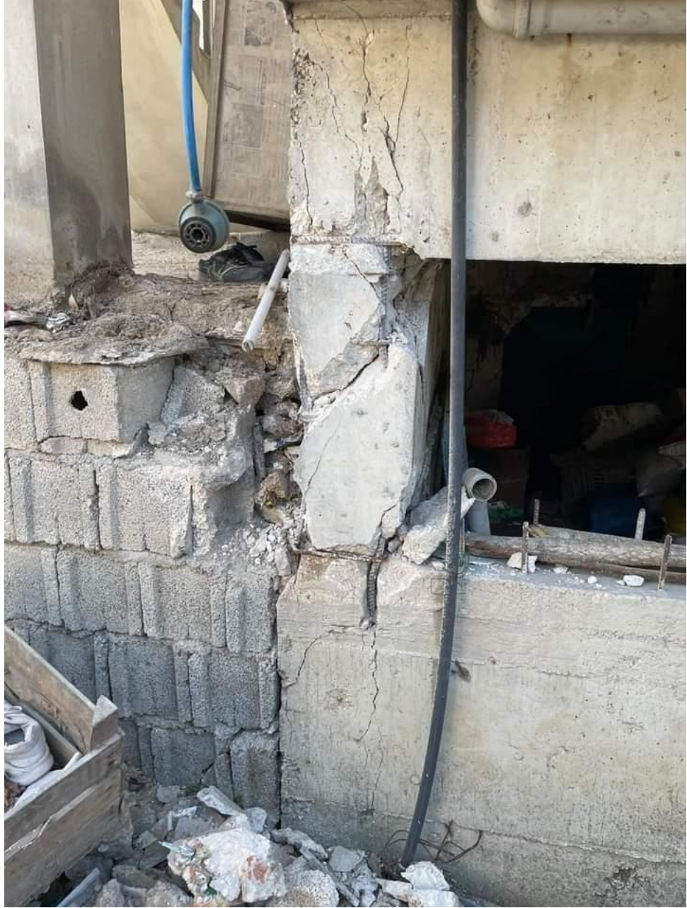
Şekil 40. Kolon Kesme Kuvveti Kaynaklı Hasar
