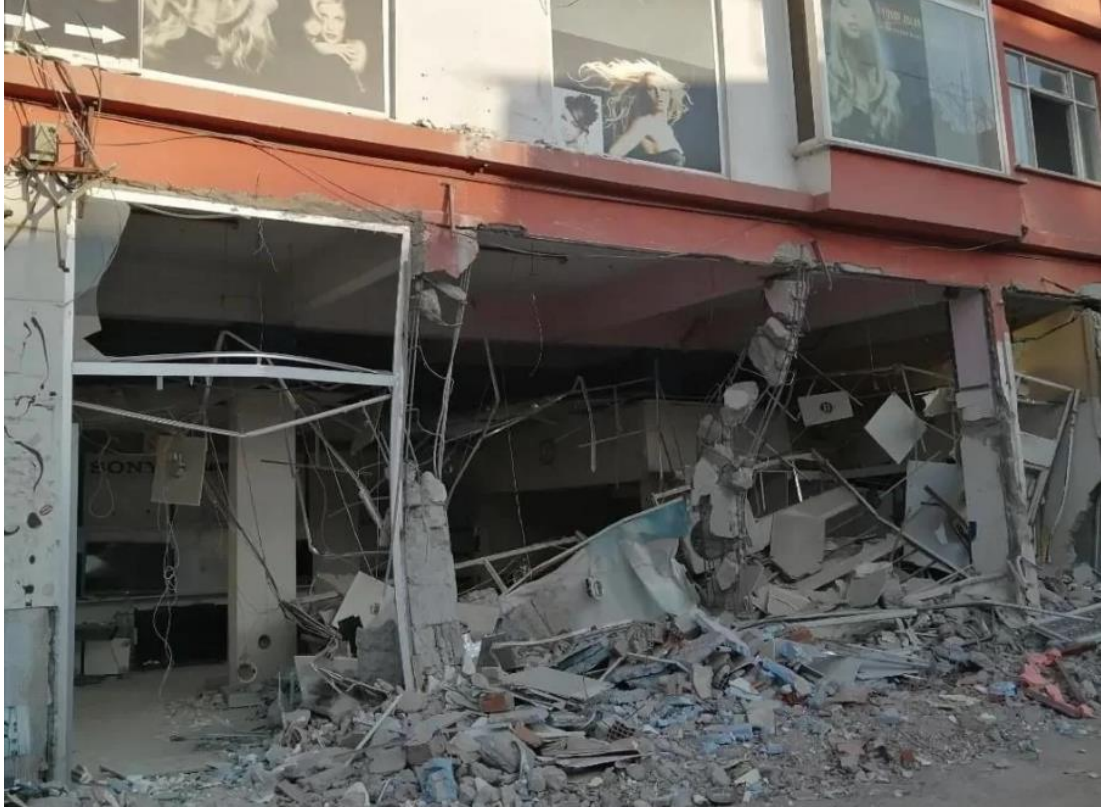
Şekil 41. Yumuşak Kat Hasarı
