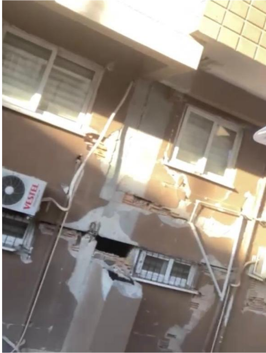
Şekil 37. Kısa Kolon Kaynaklı Hasar
