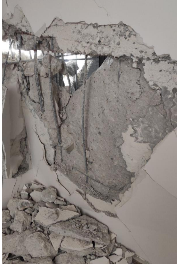
Şekil 43. Donatı Yetersizliğinden Kaynaklanan Hasar
