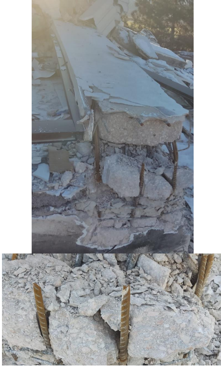
Şekil 32. Malzeme Kalitesizliğinden Kaynaklı Hasar
