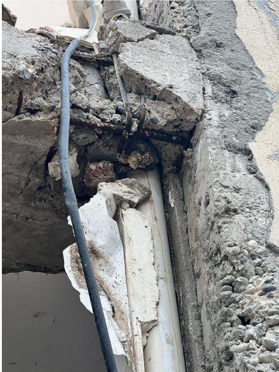
Şekil 38. Birleşim Bölgesi Kaynaklı Hasar
