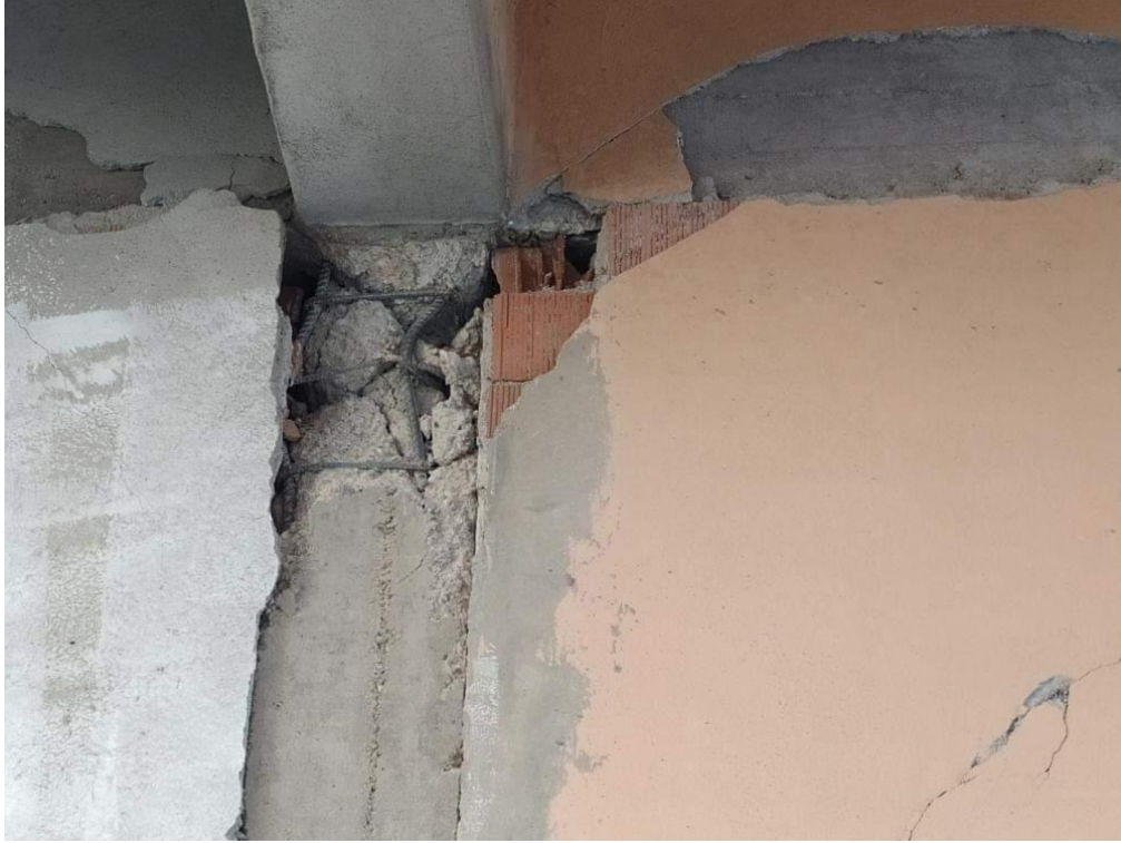
Şekil 39. Kolonda Burkulma Kaynaklı Hasar
