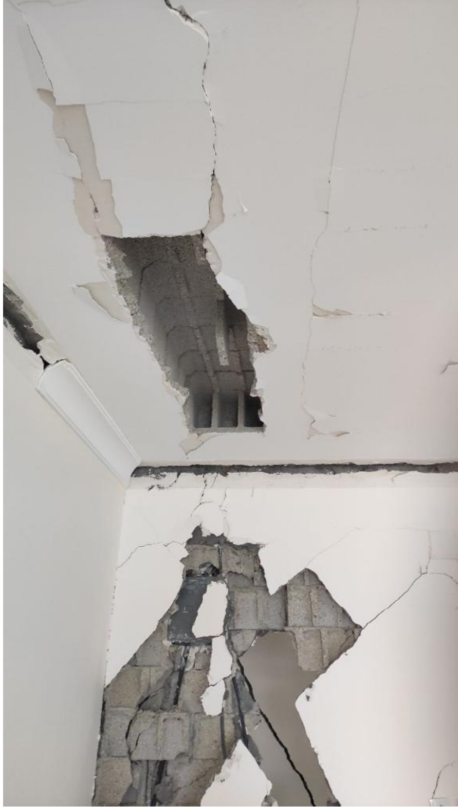
Şekil 34. Asmolen Döşeme Kaynaklı Hasar
