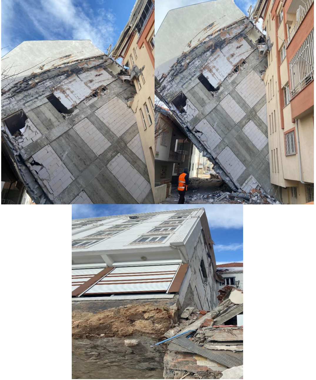
Şekil 31.Zemin Sıvılaşmasından Kaynaklı Hasar
