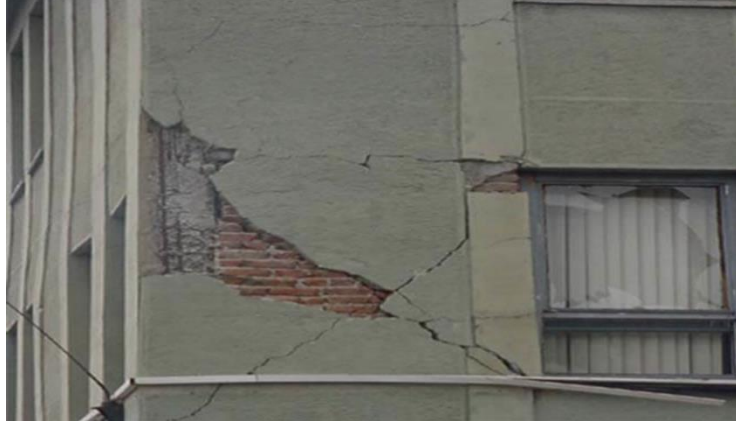
Şekil 2. Dolgu Duvar Hasarı
