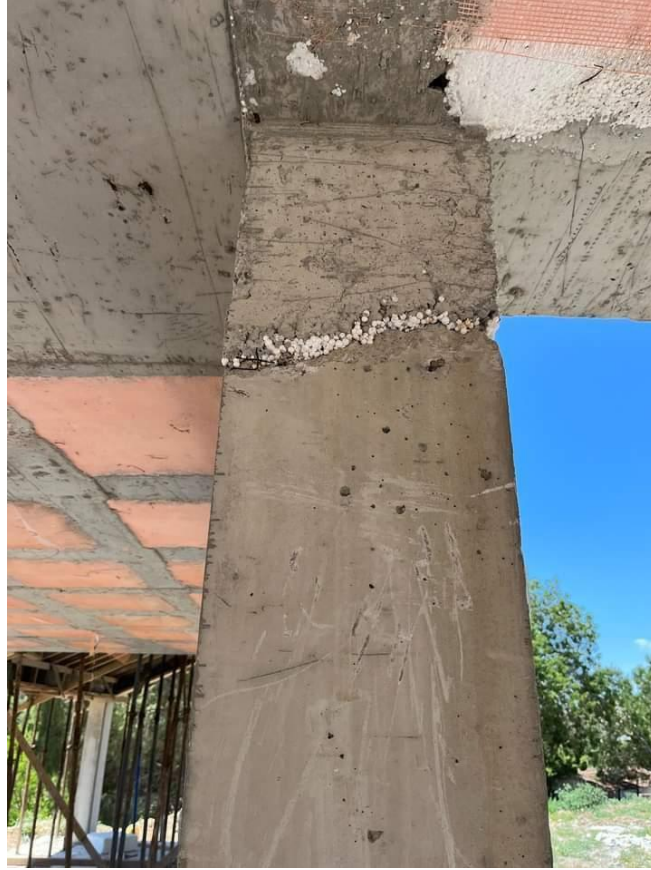
Şekil 35. Betona Yabancı Madde Karışmasından Kaynaklı Hasar
