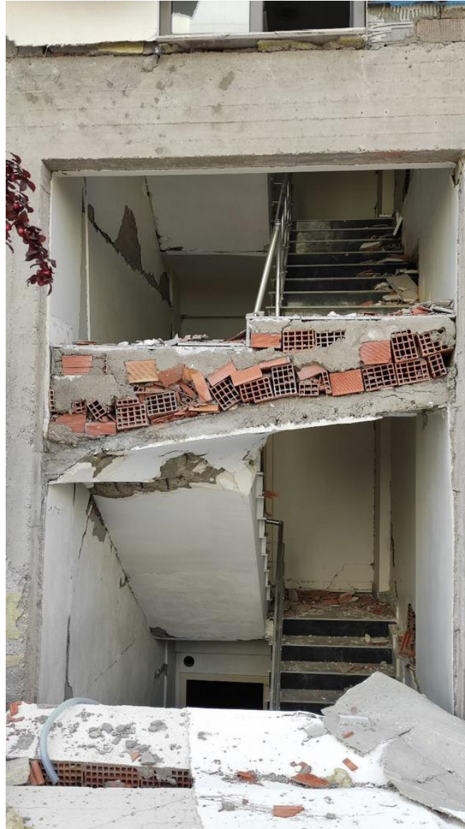
Şekil 36. Merdivende Uygulama Kaynaklı Hasar
