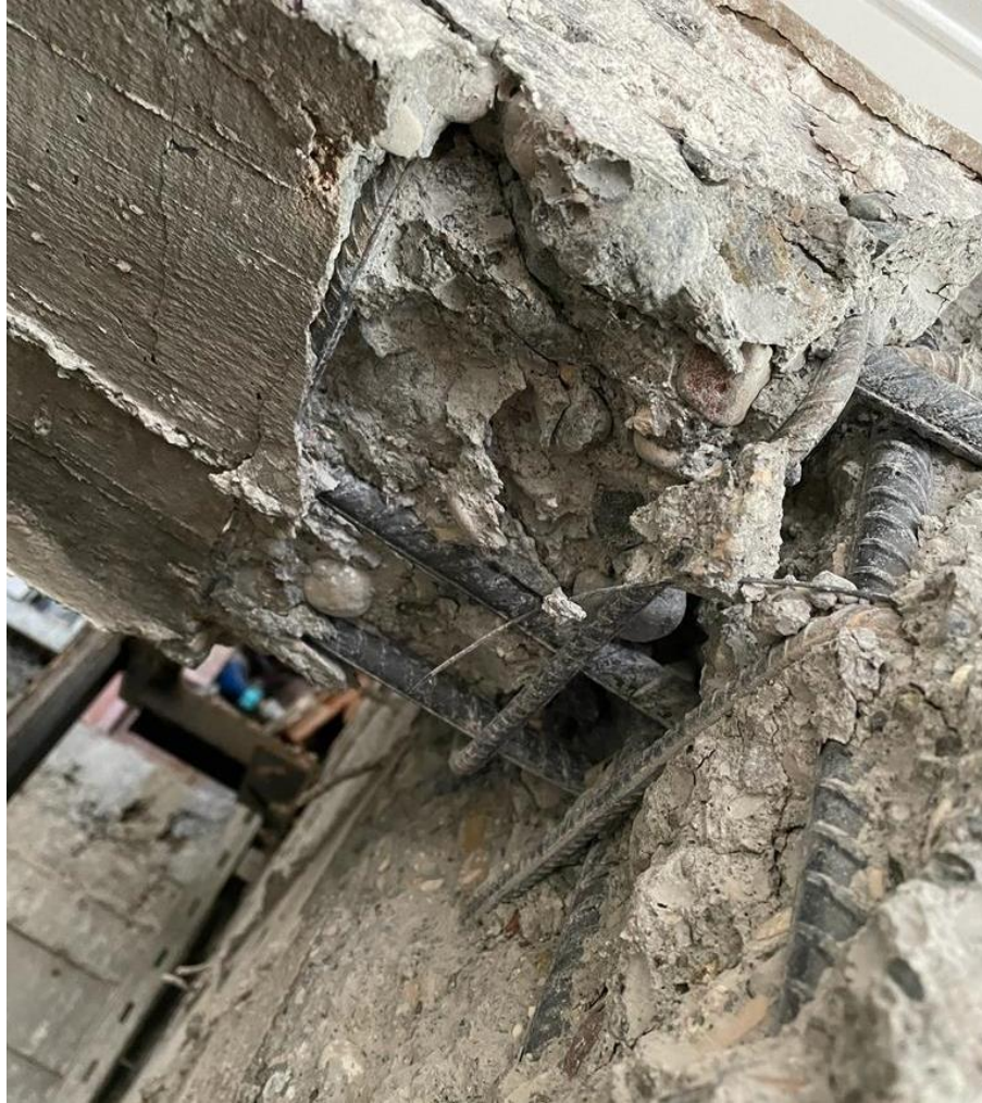
Şekil 21. Kötü malzemeli beton
