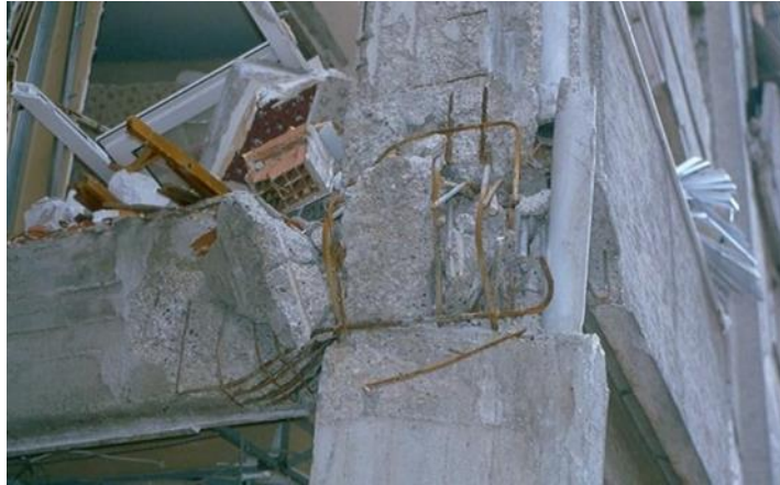
Şekil 7. Düğüm Noktası Hasarı
