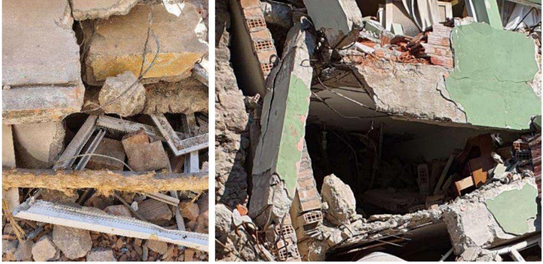
Şekil 42. Güçlü Kiriş Zayıf Kolon Hasarı
