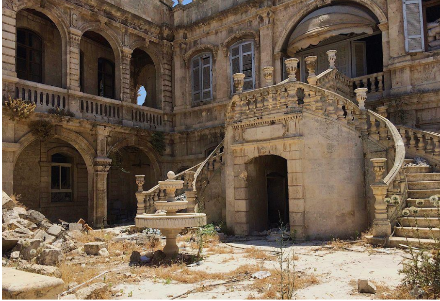
Şekil 65 Sayadiye Evi, Hasara Uğramış Evin Zemin ve Üst Kat Revakları
