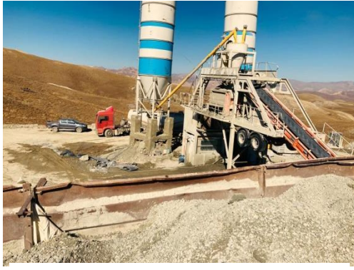
Şekil 36 Mobil Beton Santrali
