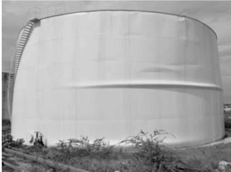
Şekil 12. Orta duvar seviyesinde filin diz bükülmesi gelişti
