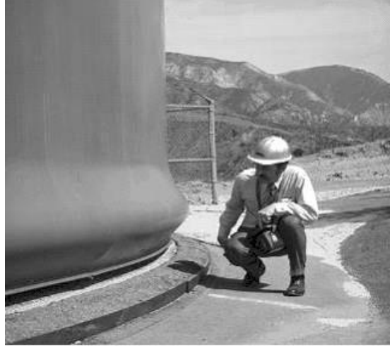
Şekil 11. Alt duvar seviyesinde filin ayak burkulması gelişti
