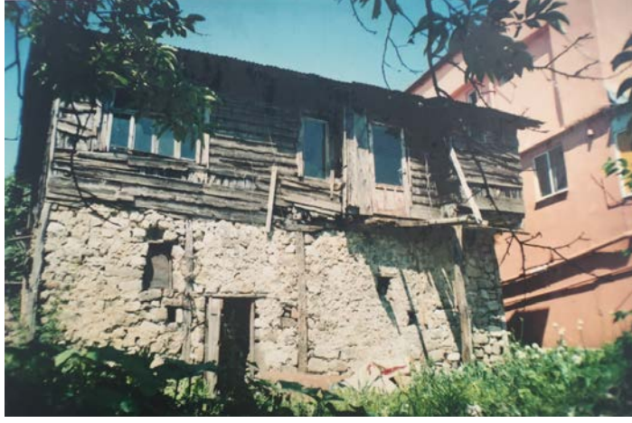
Şekil 4. 95: Restore öncesi evin arka cephesi (Zor, 2015)
